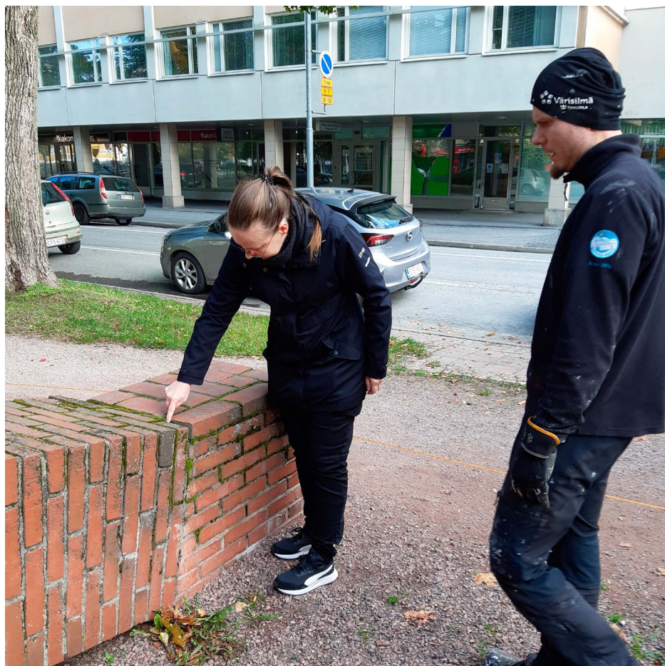
Per Kirkebyn Tiiliveistoksen kuntoa tarkastellaan taidemuseon konservattori Janita Niemisen johdolla. Maalausteho Oy puhdistaa Per Kirkebyn Tiiliveistosta. Kuvat: Anni Saisto Porin taidemuseo
