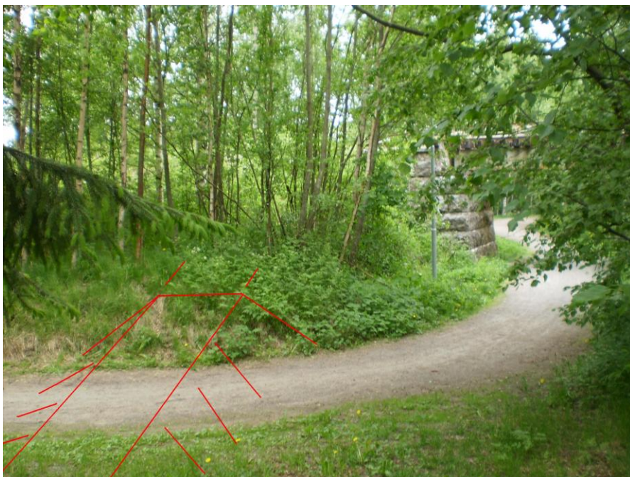
Kuva 2.6. Pato on rikottu kevyen liikenteen väylällä. Rautatiesilta. Eteläranta.
