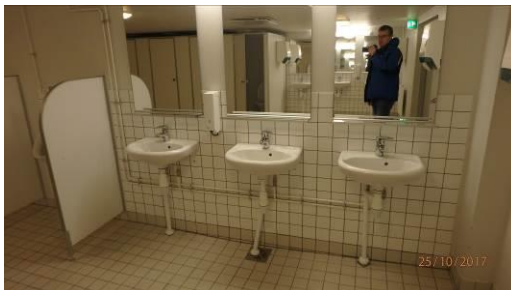
Käyttövesiverkoston putkea WC-tilassa.
