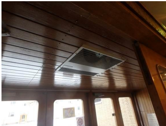
Rakennuksessa on myös kiertoilmakojeita.
