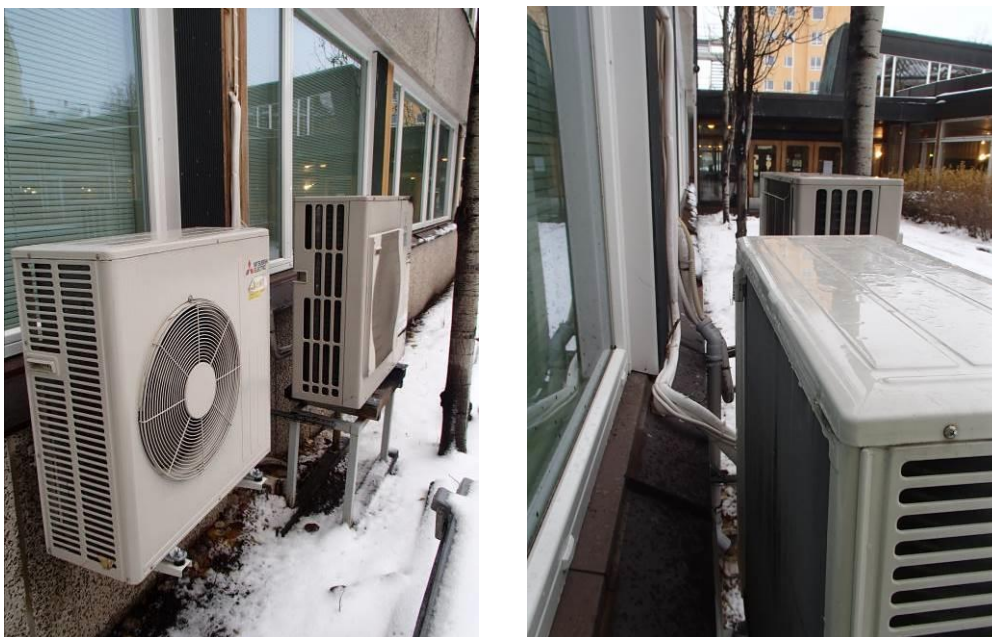
LVI-laitteiden ulkoyksiköitä rakennuksen seinustalla sisäpihan puolella.
