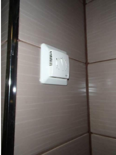
Opetustilojen pesuhuonetilassa on sähköinen lattialämmitys.
